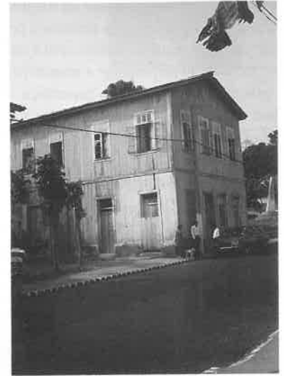
Vista geral da igreja «Arautos do Rei». É construída toda em madeira e o primeiro andar está em ruínas. Está bem localizada. Dá para duas ruas asfaltadas e fica no centro da cidade.
